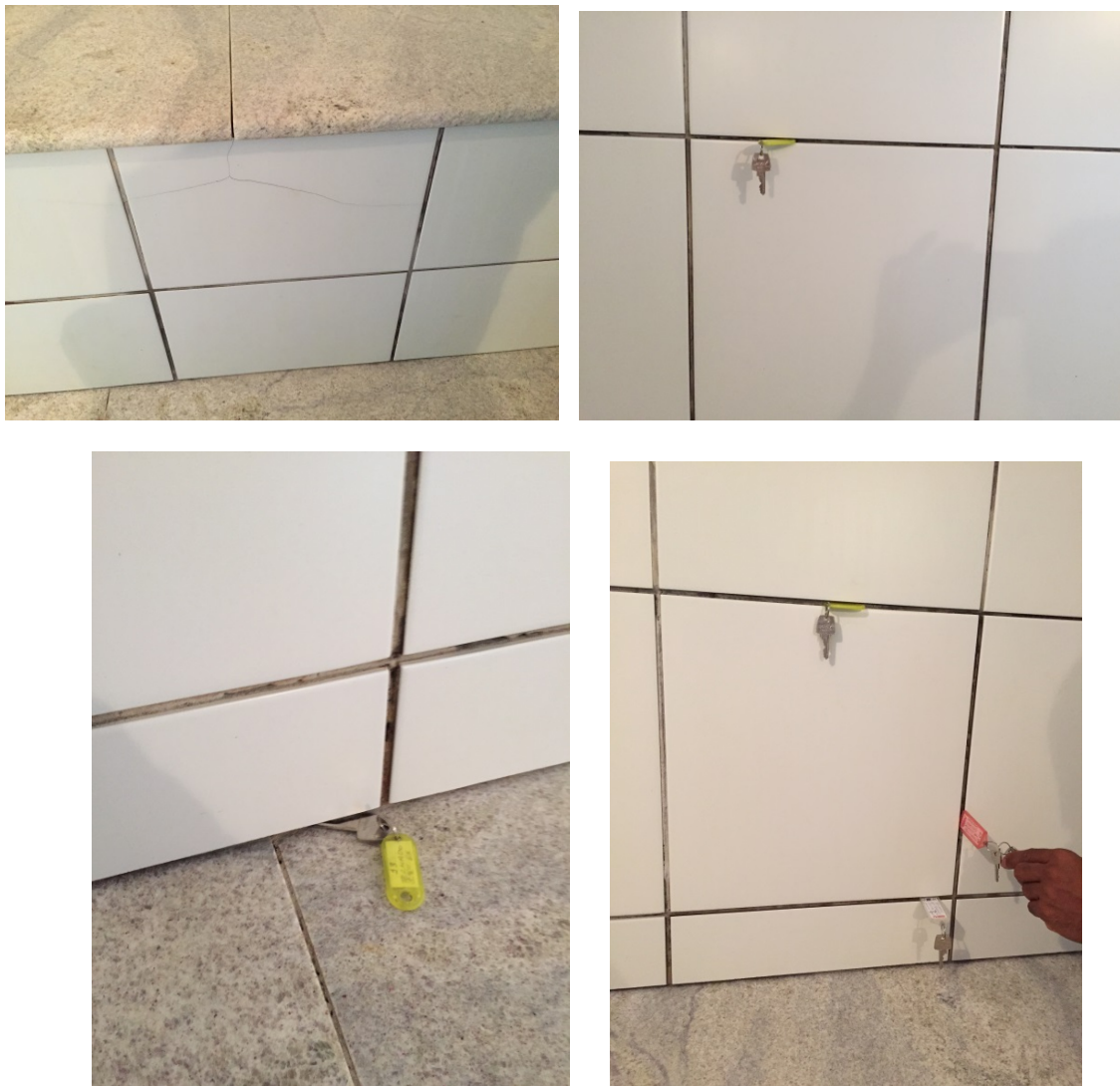
Ausência de rejunte no granito e nos azulejos da sauna do clube
