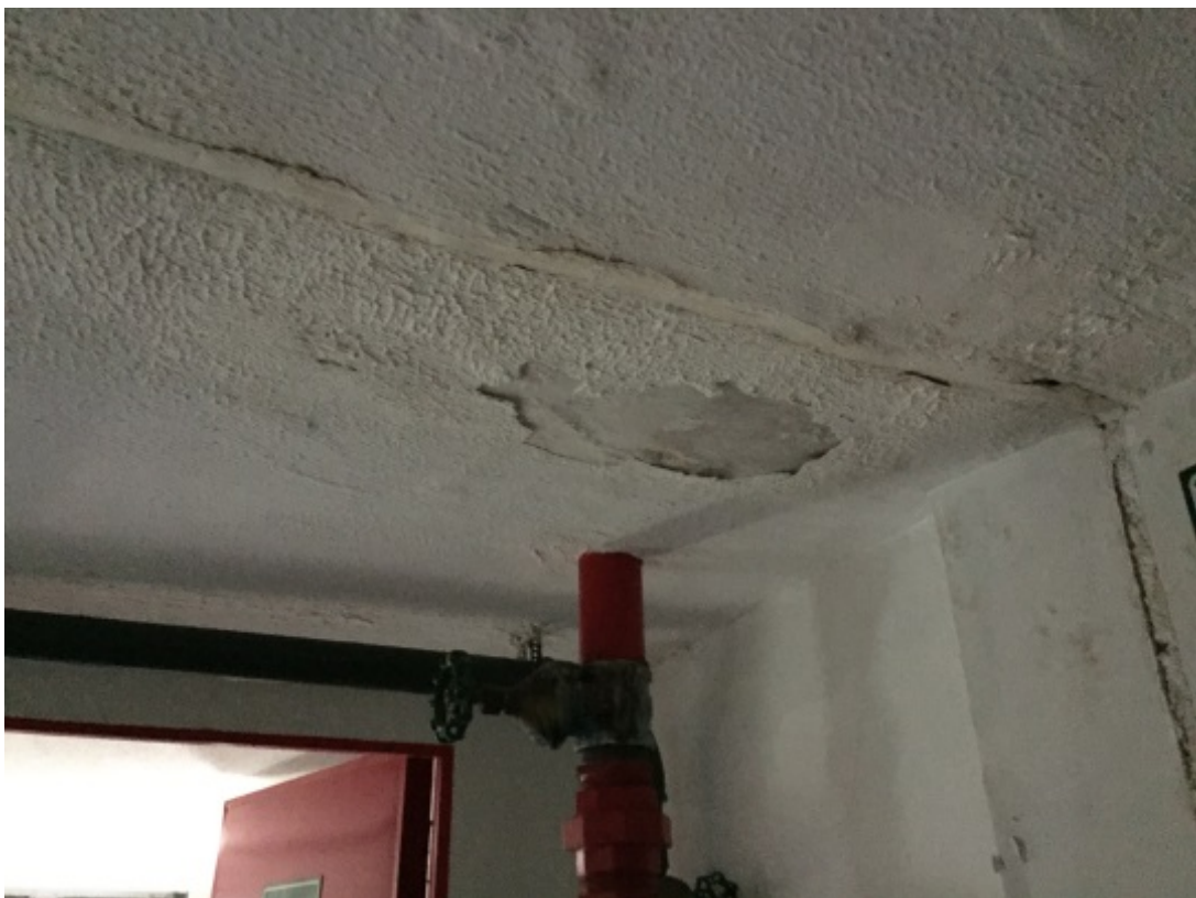
Infiltração dentro da escada de emergência – bloco B – embaixo do reservatório superior
