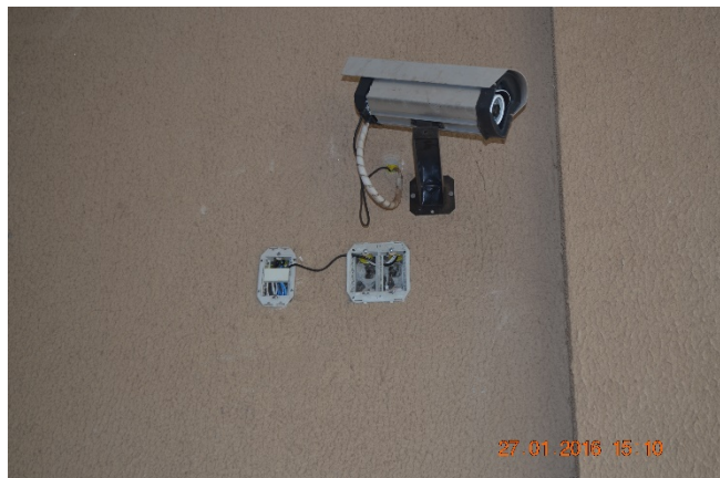
Fiação exposta - Passagem entre blocos C e D
