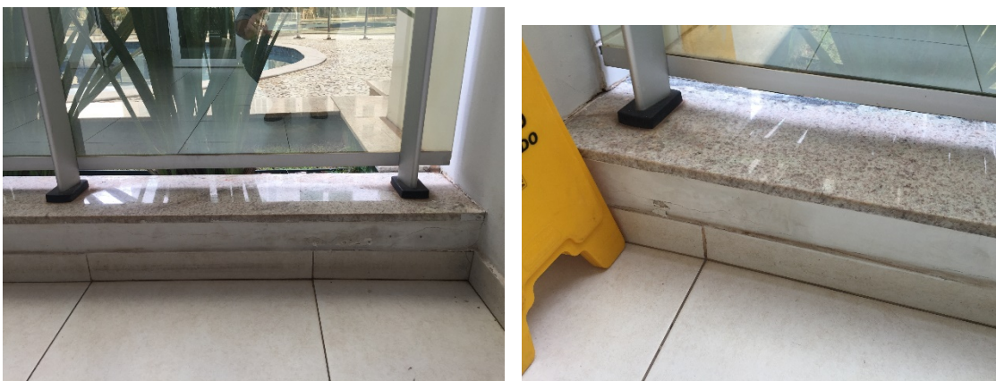
Mureta com pintura descascando na entrada da academia
