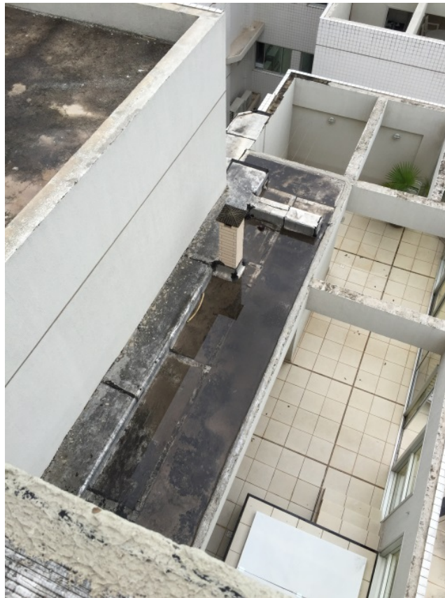
Acumulo de água – Cobertura bloco A
