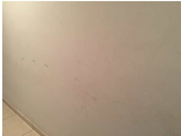
Pintura danificada – corredor 19º andar bloco A
