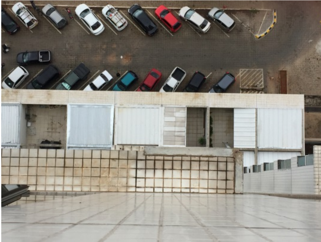
Falta de rejunte fachada – bloco A
