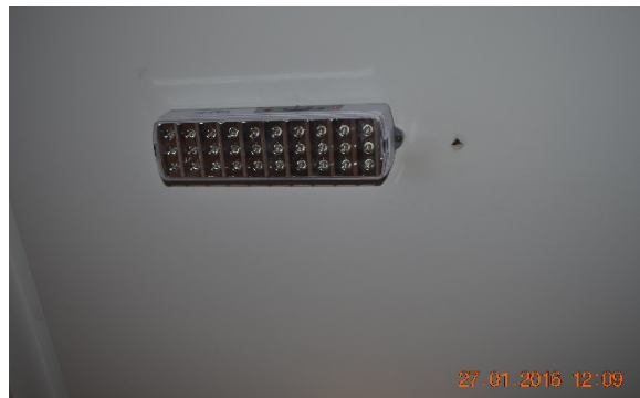
Luzes de emergência não funcionam - Bloco A
