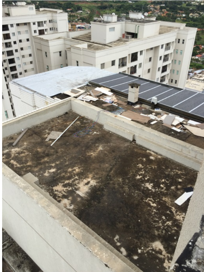
Entulho na cobertura bloco A
