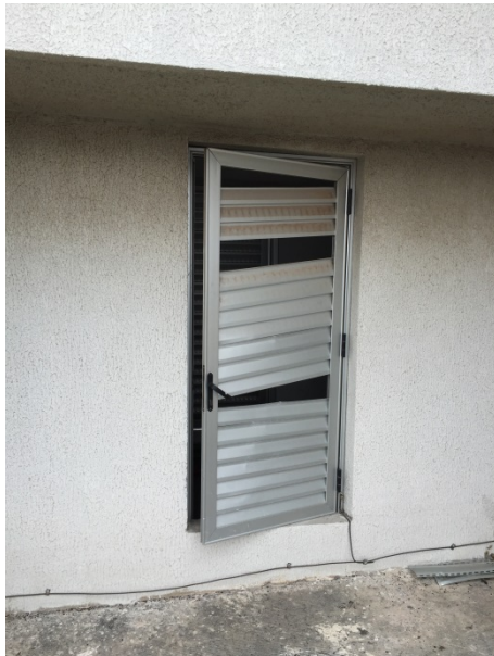
Porta de acesso à cobertura do bloco A danificada.
