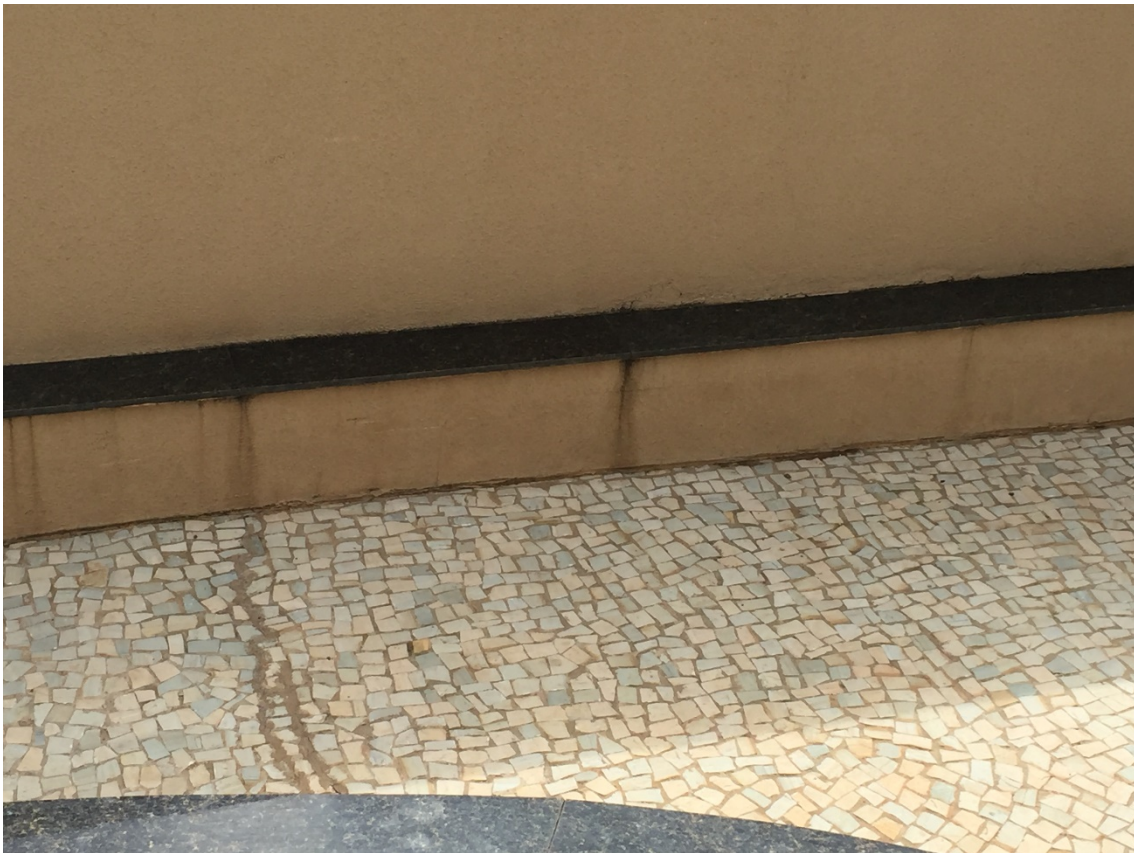
Ausência de rejunte no granito e de reparo na junta da base mureta de jardim; trincas em toda a mureta de jardim na área comum do condomínio
