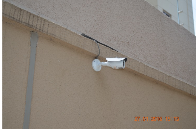
Câmeras com fiação exposta
