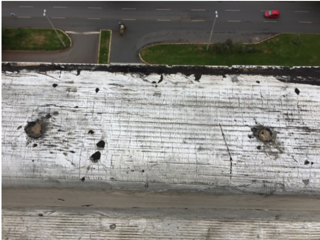
Furos na manta de impermeabilização da cobertura Bloco A para a instalação de cordoalha de aterramento, que atualmente foi transferida para a parede
