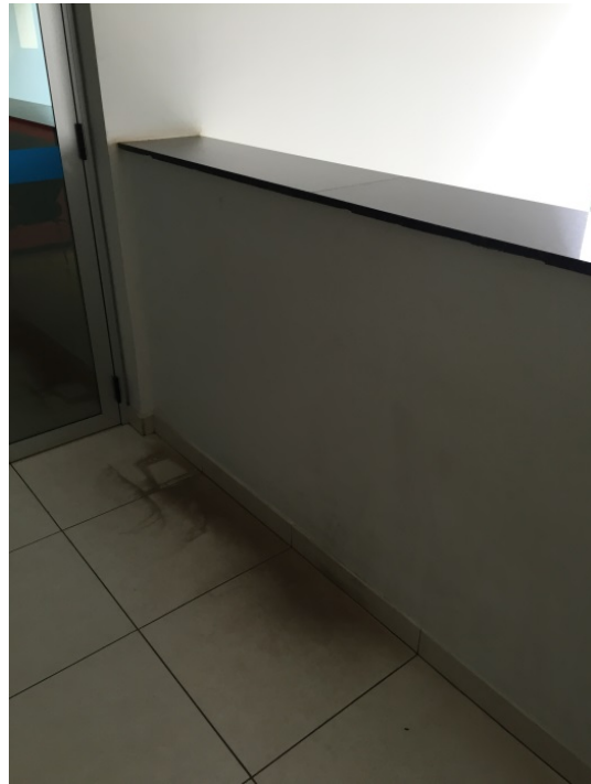
Piso manchado – mezanino bloco A
