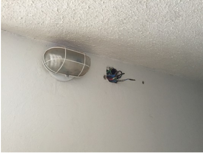
Falta luminária de emergência na escada de incêndio bloco A (ultima andar)
