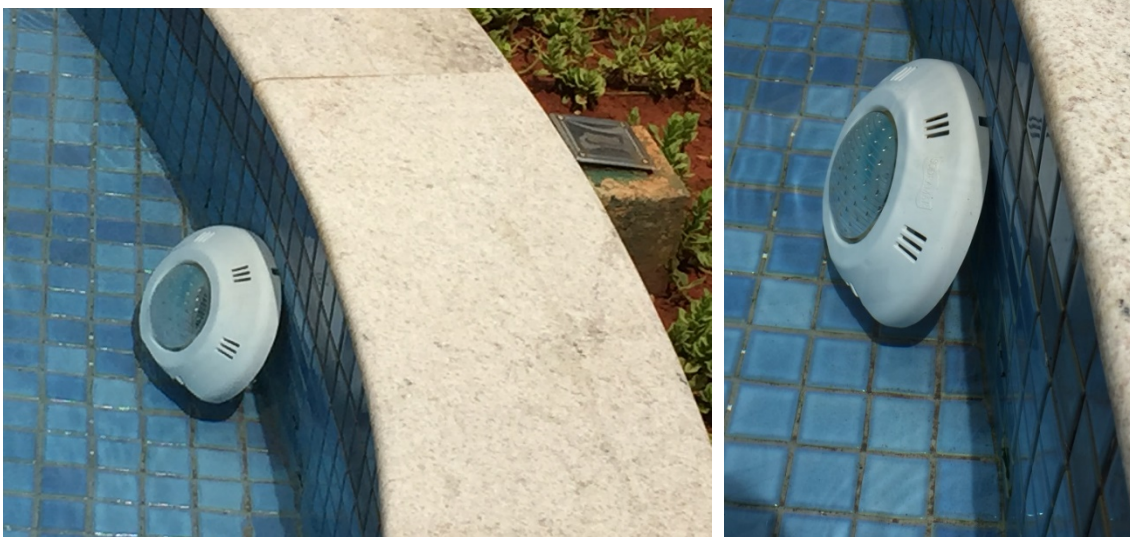
Iluminação da piscina solta e ausência de rejunte neste local
