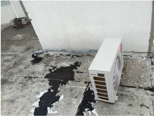
Aparelho de ar condicionado instalado na cobertura do bloco A
