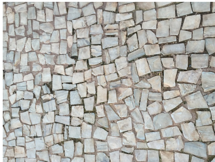
Piso de pedra portuguesa com trincas e ausência de reparo entre as peças
