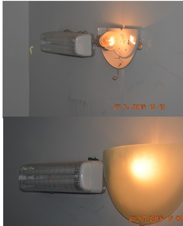
Fiação exposta - Escadas entre 12º e 11º.
