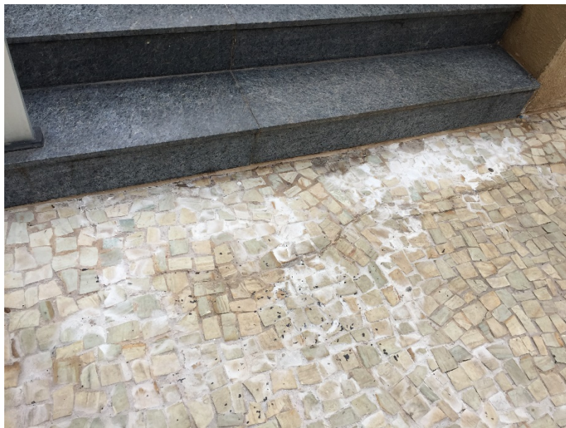
Ausência de rejunte, junta de vedação solta no encontro do piso com o granito e infiltração por baixo das pedras portuguesas
