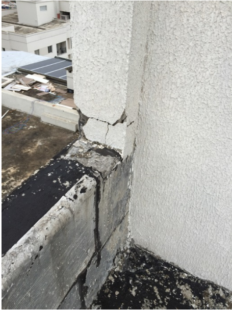
Trinca – cobertura bloco A
