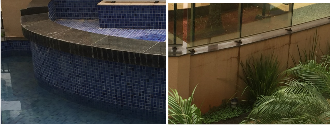
Ausência de rejunte no granito e trincas no muro no nível da piscina
