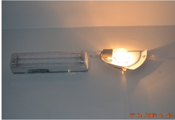
Luminária quebrada na escada entre 19º e 18º.
