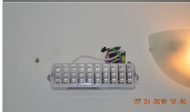
Fiação exposta - Escadas entre 16º e 15º.
