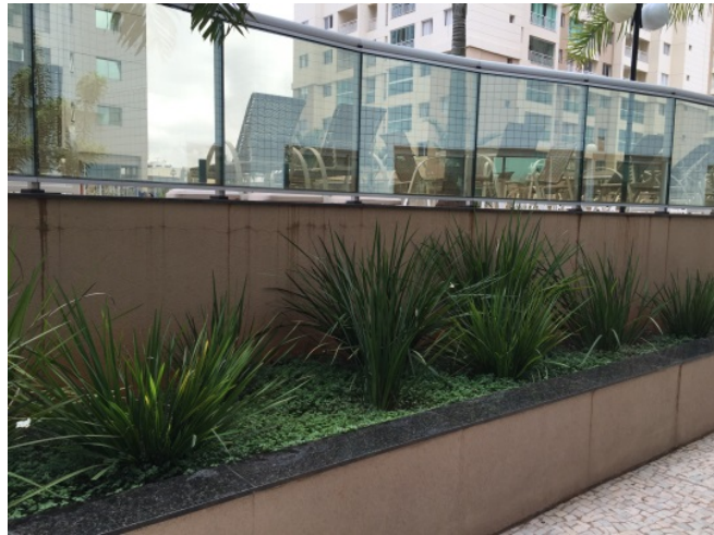
Trinca e sinal de infiltração deck piscina
