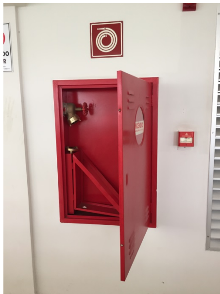
Falta mangueira de incêndio – mezanino A
