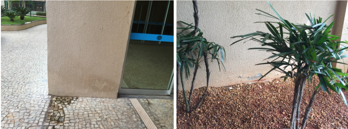
Ponto de infiltração na fachada e pintura descascada acima da floreira, entre a cobertura dos blocos C e D
