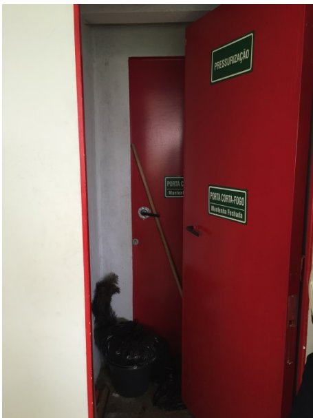
Antecâmara do cômodo de pressurização das escadas como depósito de baldes e vassouras – Mezanino bloco A
