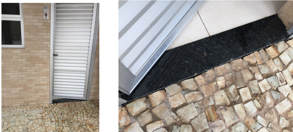
Piso de pedra portuguesa danificado e sem rejunte na frente dos banheiros da piscina
