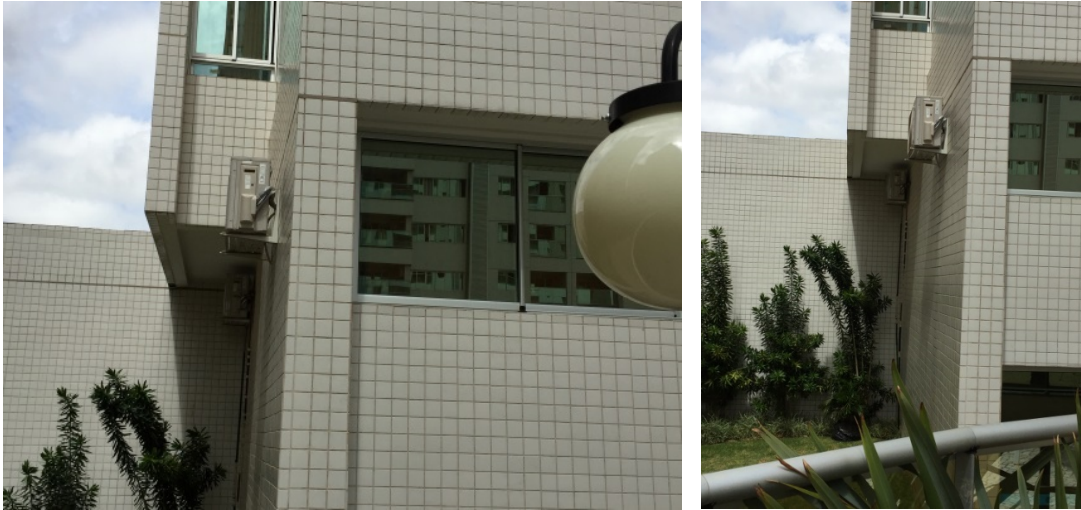
Ar-condicionado na área de cinema instalada posteriormente pelo condomínio
