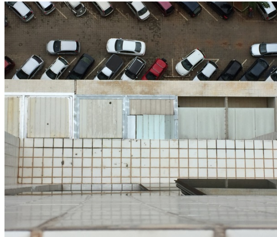
Falha no rejunte da fachada na cobertura do bloco B
