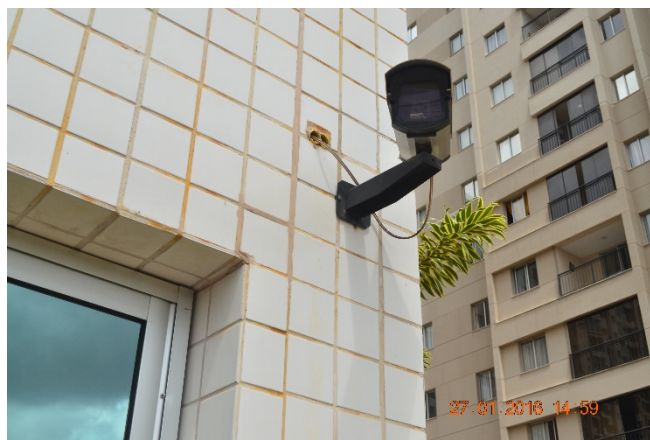
Fiação de câmera exposta - Em frente ao Playground
