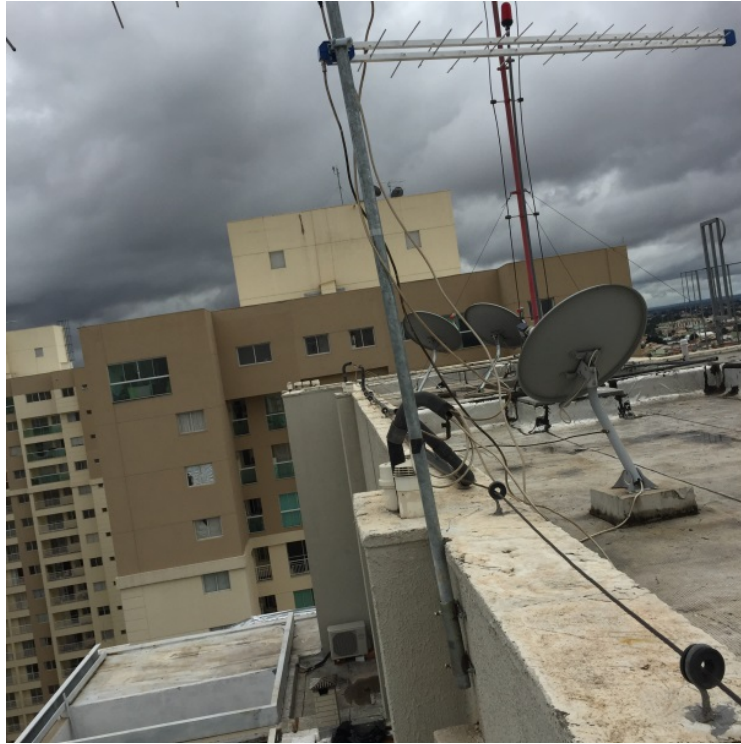
Fixação original da antena, por fora da fachada – Bloco B
