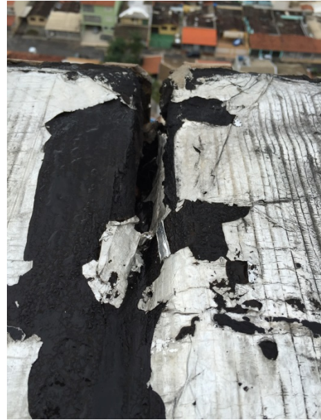
Manta de impermeabilização danificada na cobertura do bloco A
