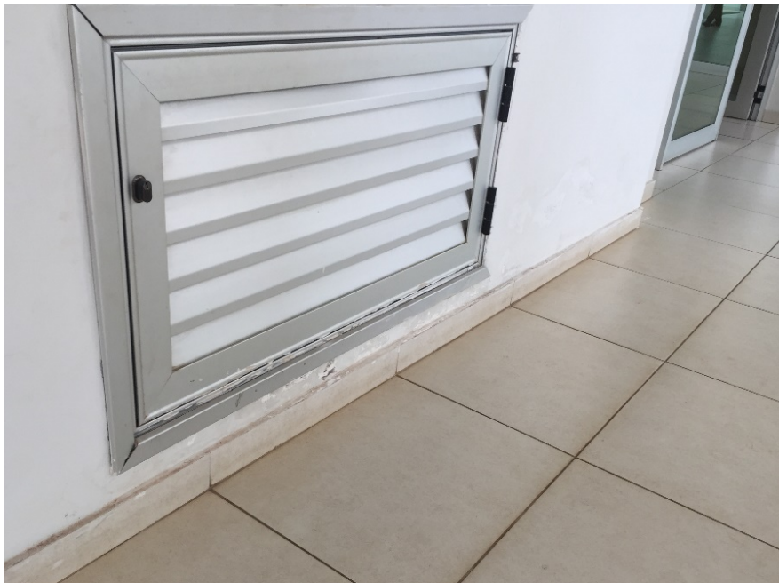
Parede com pontos de infiltração devido a problema de operação no equipamento da Sauna e sem reparo pelo condomínio
