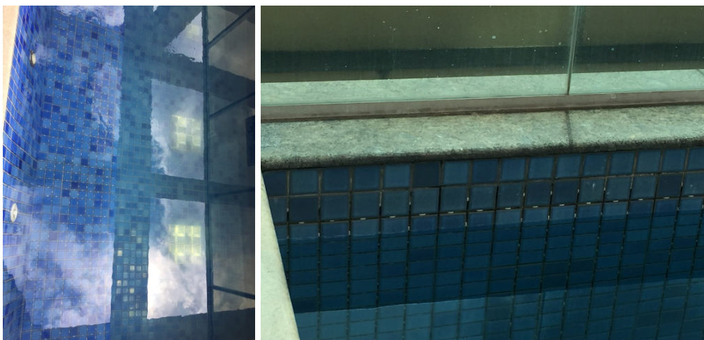
Ausência de rejunte no fundo e borda lateral, na pastilha da piscina aquecida do clube
