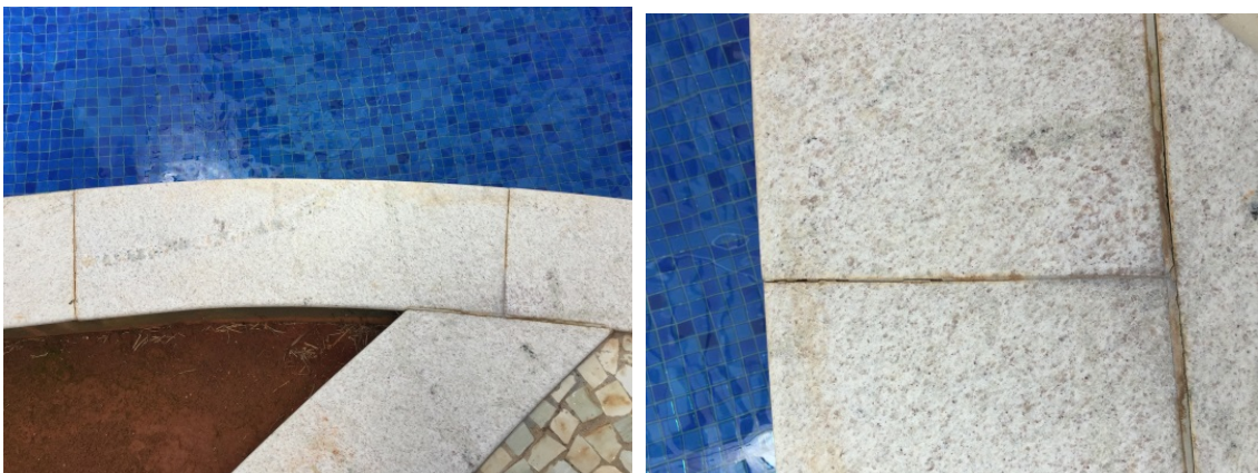
Bordas das piscinas sem rejunte entre as pedras
