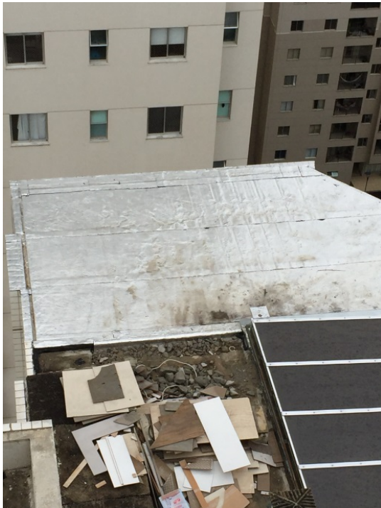
Entulho na cobertura bloco A
