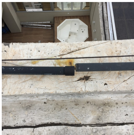
Cabeamento das antenas coletivas instaladas por empresas como SKY, Oi, entre outras fixadas diretamente na manta de impermeabilização – Cobertura bloco B.
