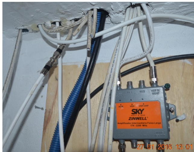
Caixa CFTV - 10º andar do Bloco A com cabos sem identificação ou encaminhamento adequado.
