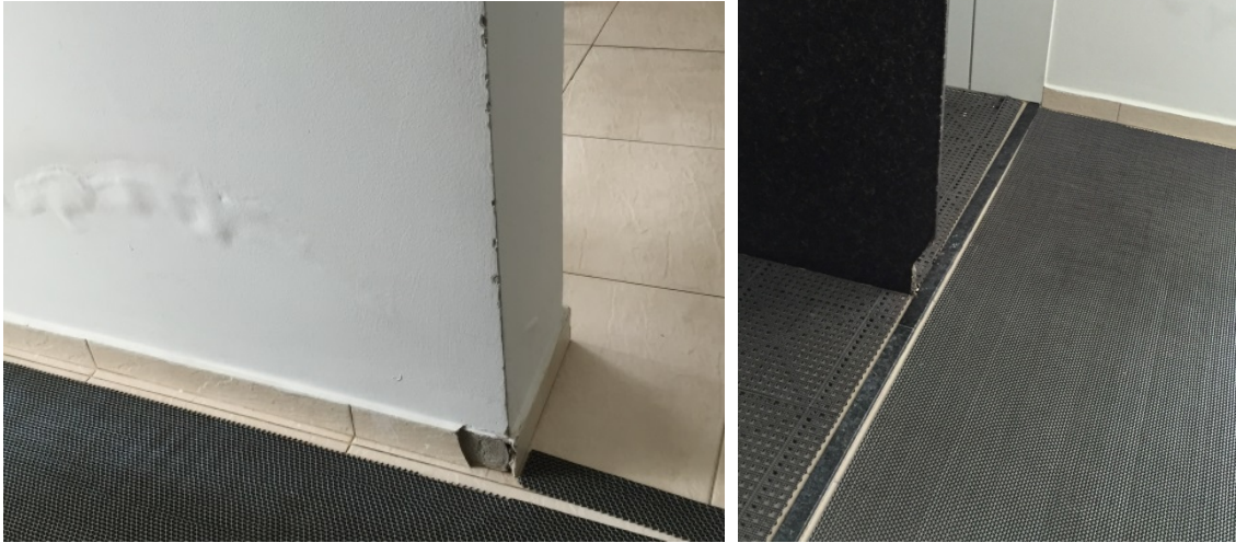
Acesso a sauna com infiltração na parede e divisória de granito do chuveiro quebrada
