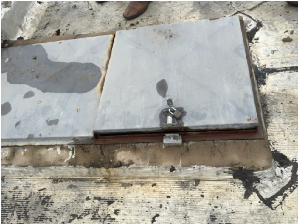
Alçapão do reservatório superior aberto – bloco A
