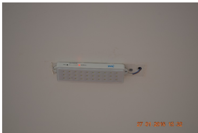
Fiação exposta - Em frente ao salão de beleza
