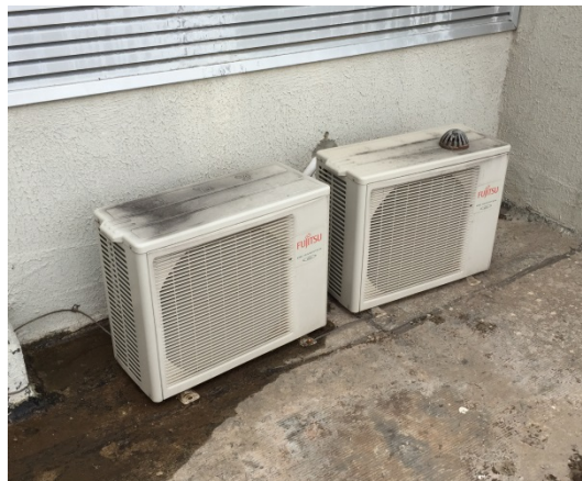
Instalação de ar condicionado com buracos feitos na parede, na altura da manta de impermeabilização – cobertura bloco B
