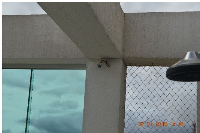
1 - Fiação de câmera exposta - Piscina
