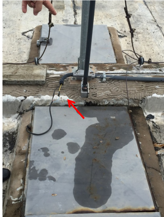
Fiação exposta – cobertura bloco A
