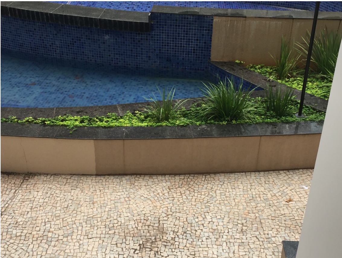
Ausência de rejunte no granito e trincas no muro, sendo pintado sem a devida correção das falhas
