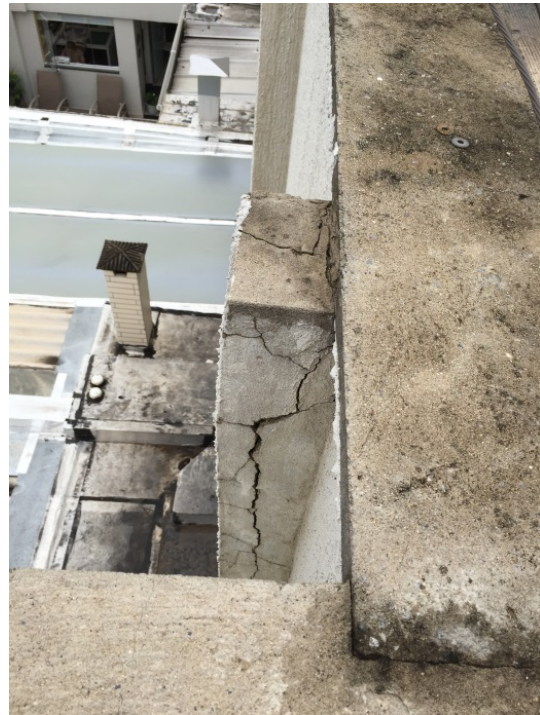
Trincas na parede da fachada na cobertura bloco A
