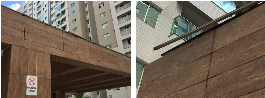
Telhado realizado pelo condomínio na área de apoio da piscina, com acabamento solto e sem calha para captação das águas da cobertura
