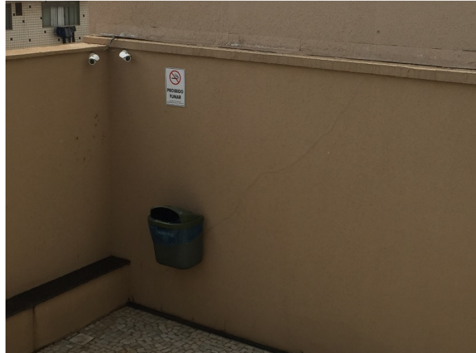
Trinca no muro de divisa com vizinho
