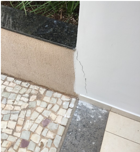
Fissura – pilotis bloco B
