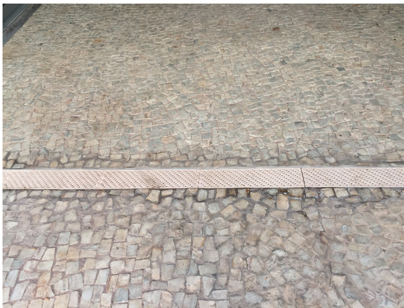
Ausência de rejunte na pedra portuguesa ao redor da grelha de captação de água de chuva entre os blocos C e D
