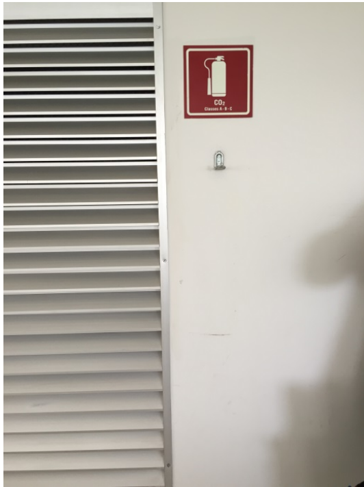
Falta extintor – mezanino bloco A
